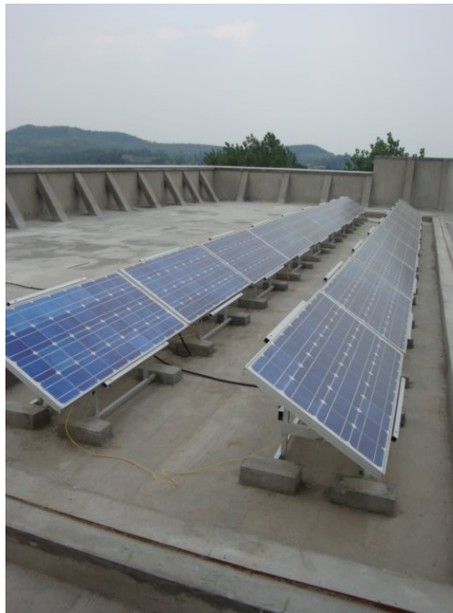
安裝完成的太陽能板
